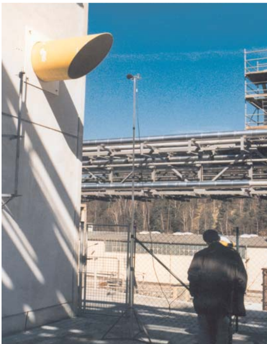
Pegelmessung Abgaskanal einer Gasanlage
